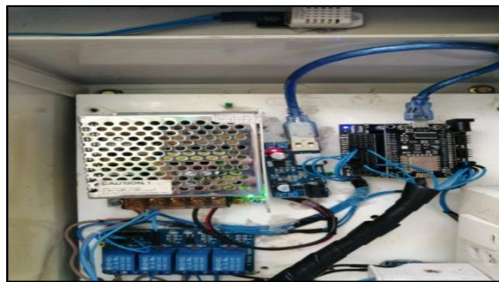
รูปที่ 3 อุปกรณ์ควบคุมการตรวจสอบอุณหภูมิ และความชื้น
