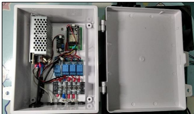
รูปที่ 5 อุปกรณ์ของระบบควบคุมและเซ็นเซอร์ต่างๆ
