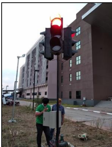
รูปที่ 1 ตรวจสอบสถานะของเวลาและการติดดับของหลอด LED
