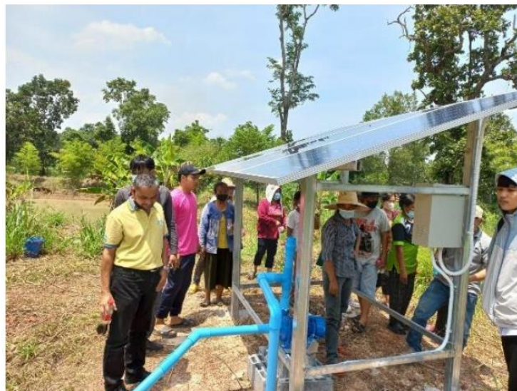
รูปที่ 3 การติดตั้งระบบ ณ กลุ่มเกษตรกรเกษตรกรอินทรีย์ บ้านโนนสะอาด ตำบลบ้านชัย อำเภอบ้านดุง จังหวัดอุดรธานี
